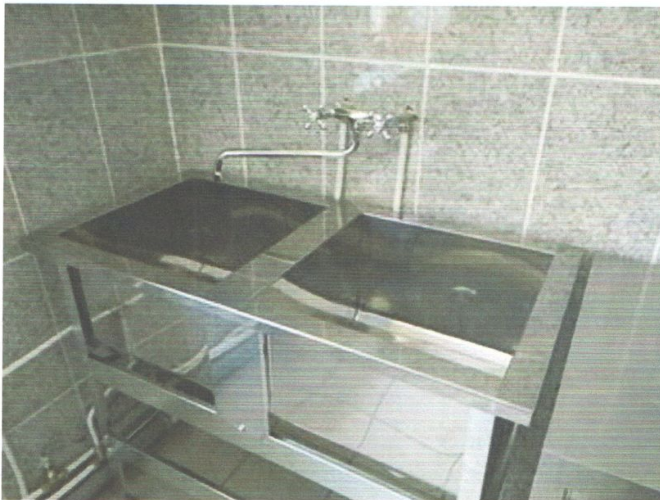
Двухсекционная мойка с подводом горячей и холодной воды в буфетном отделении стационара
